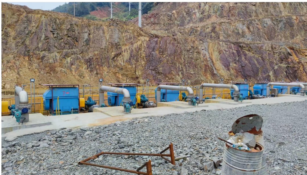
图 2.4-13 +170m 固定泵站
