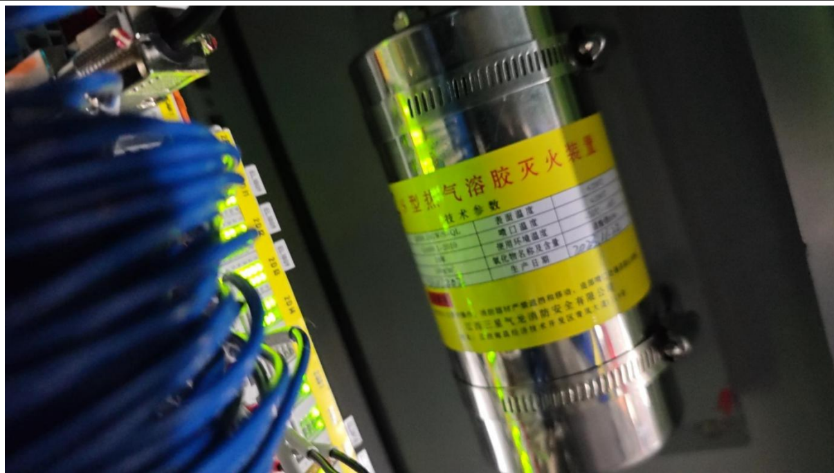
图 2.8.2-1 风力发电机舱厂家配置消防的设施
