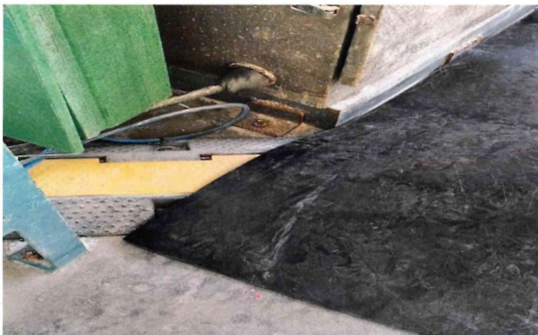
附件 9：吨包现场控制柜进出孔洞已封堵，柜前已增加绝缘垫。
