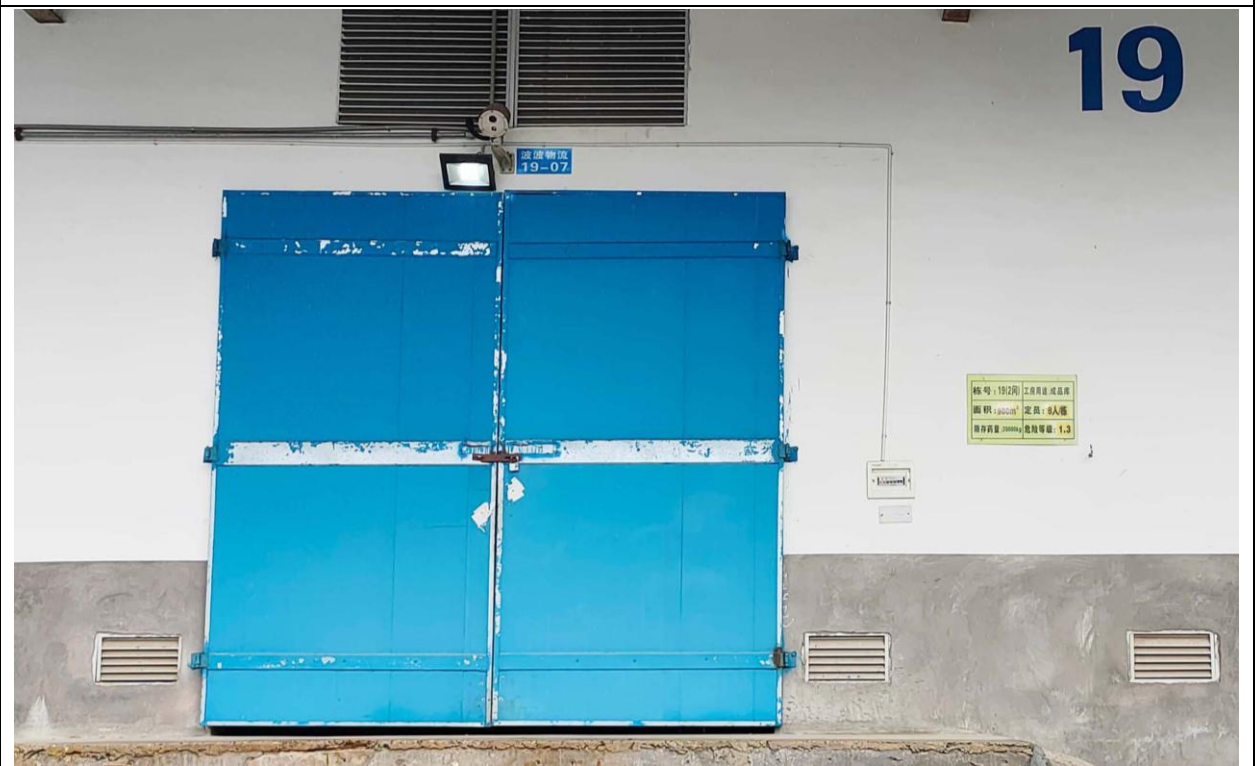
19 号成品库未配备灭火器
