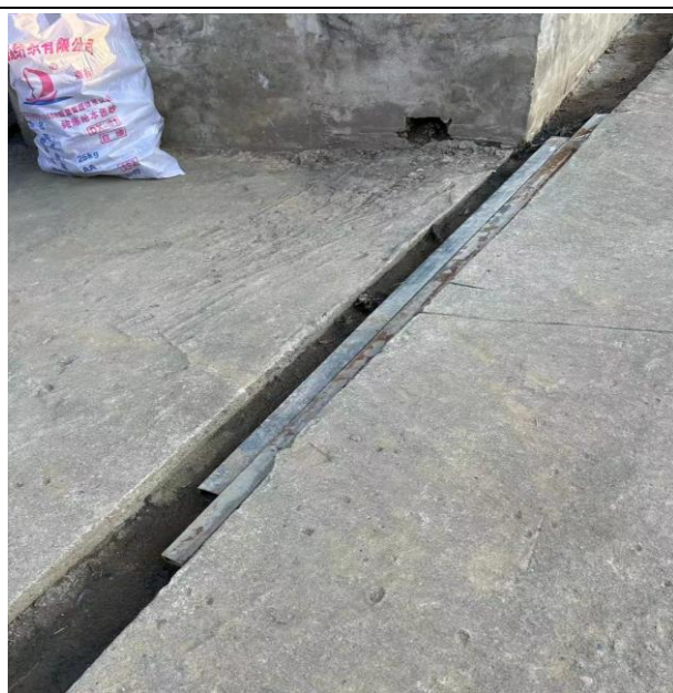
8 号及 11 号工房出口处明沟已改平
