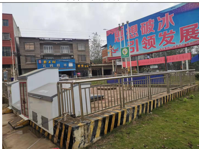
加油站油罐区
